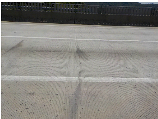
교대 A1 논산방향 접속부 포장균열(날개벽 2m 이격)
