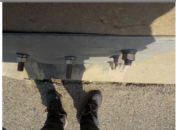
교대 A1 천안방향 날개벽 난간볼트 변형
