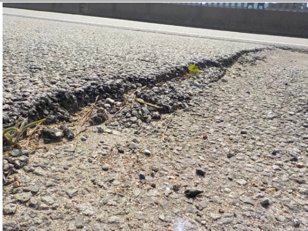
교대 A1 천안방향 접속부 포장단차(날개벽 2m 이격)
