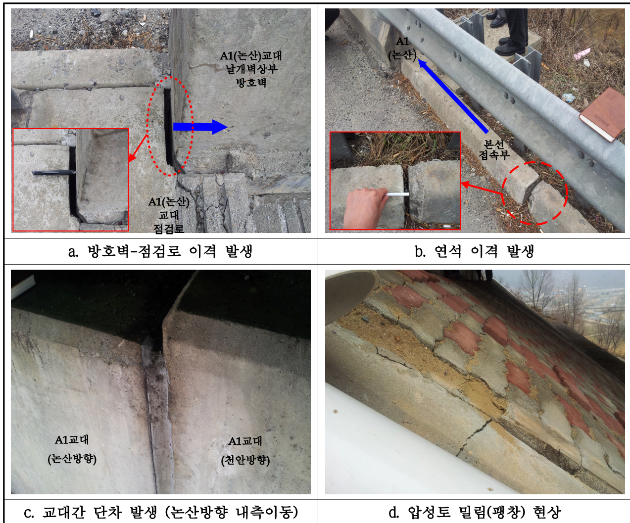
【사진 2.1】 교대 A1(논산방향) 손상발생 현황(2013진단)
