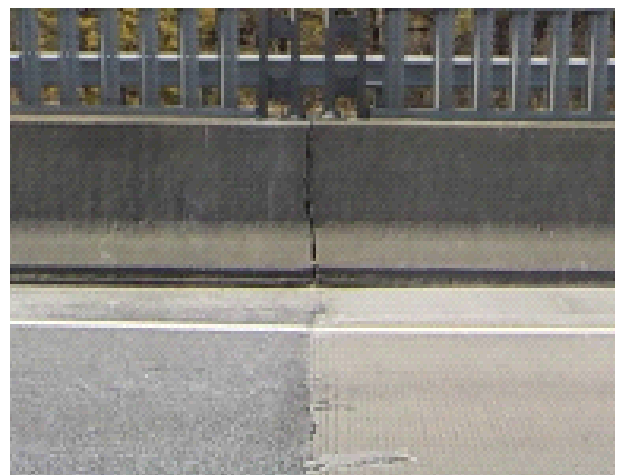
천안방향 Sta. 15.3m - 중분대 이격
