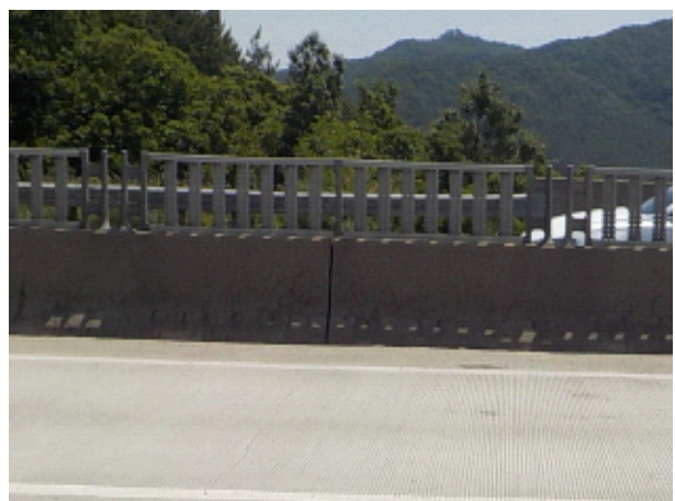
교대 A1 논산방향 접속부 방호벽 이격(날개벽 2m 이격)
