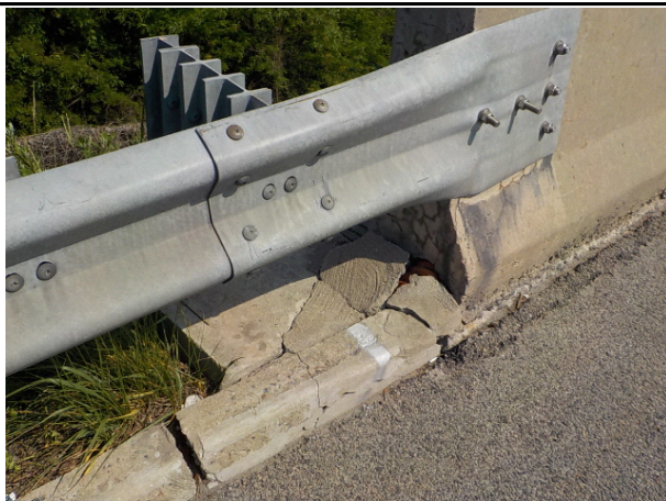
교대 A1 천안방향 접속부 경계석 파손
