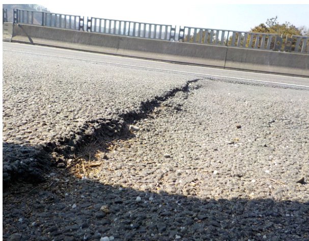
천안방향 Sta. 8.0m - 단차
