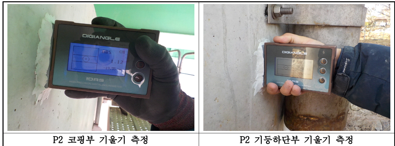
【사진 3.12】 교각 P2 기울기 측정
